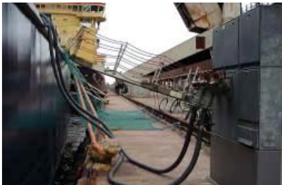
Разъёмы Cavotec в порту Гётеборга, Швеция
